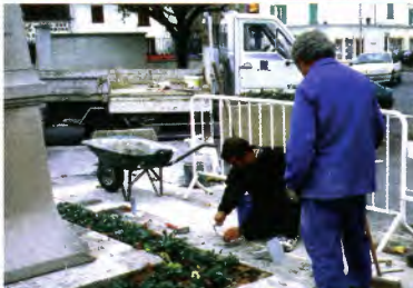
De nombreux travaux sur la voie publique sont réalisés en régie municipale.
