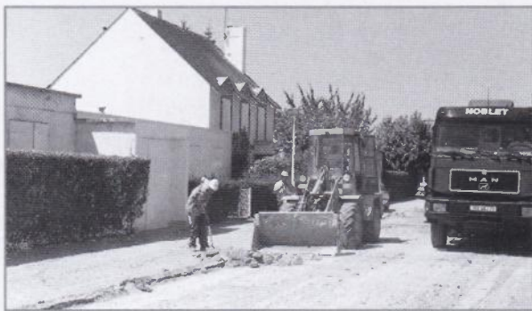
La chaussée de l'allée de la Brèche-aux-Loups, refaite cet été par une entreprise privée, ne l'a pas été avec les matériaux dont il est question dans l'article ci-contre.
