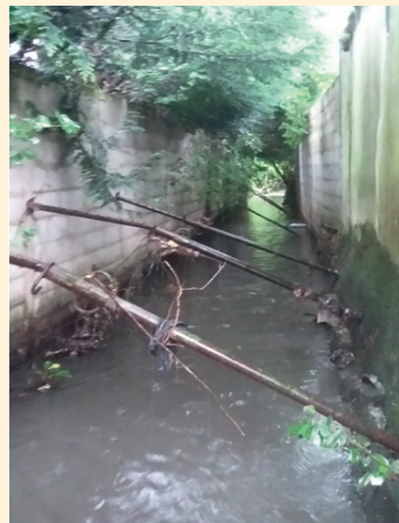
Les services techniques ont constaté lors de l'évacuation des déchets dus aux inondations, de nombreuses constructions illégales le long du ru. Des procédures sont en cours.
